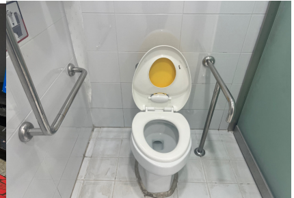
손잡이 위치가 잘못된 화장실
